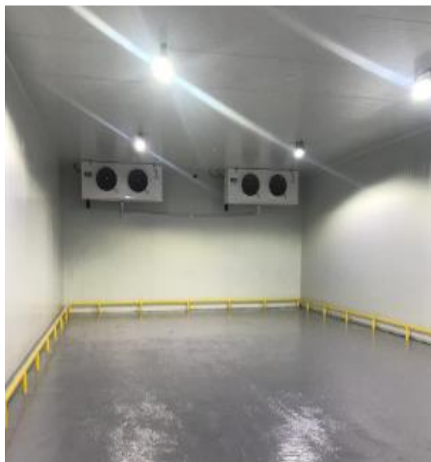
Imagen 17. Cámaras de paneles aislados térmicamente.
